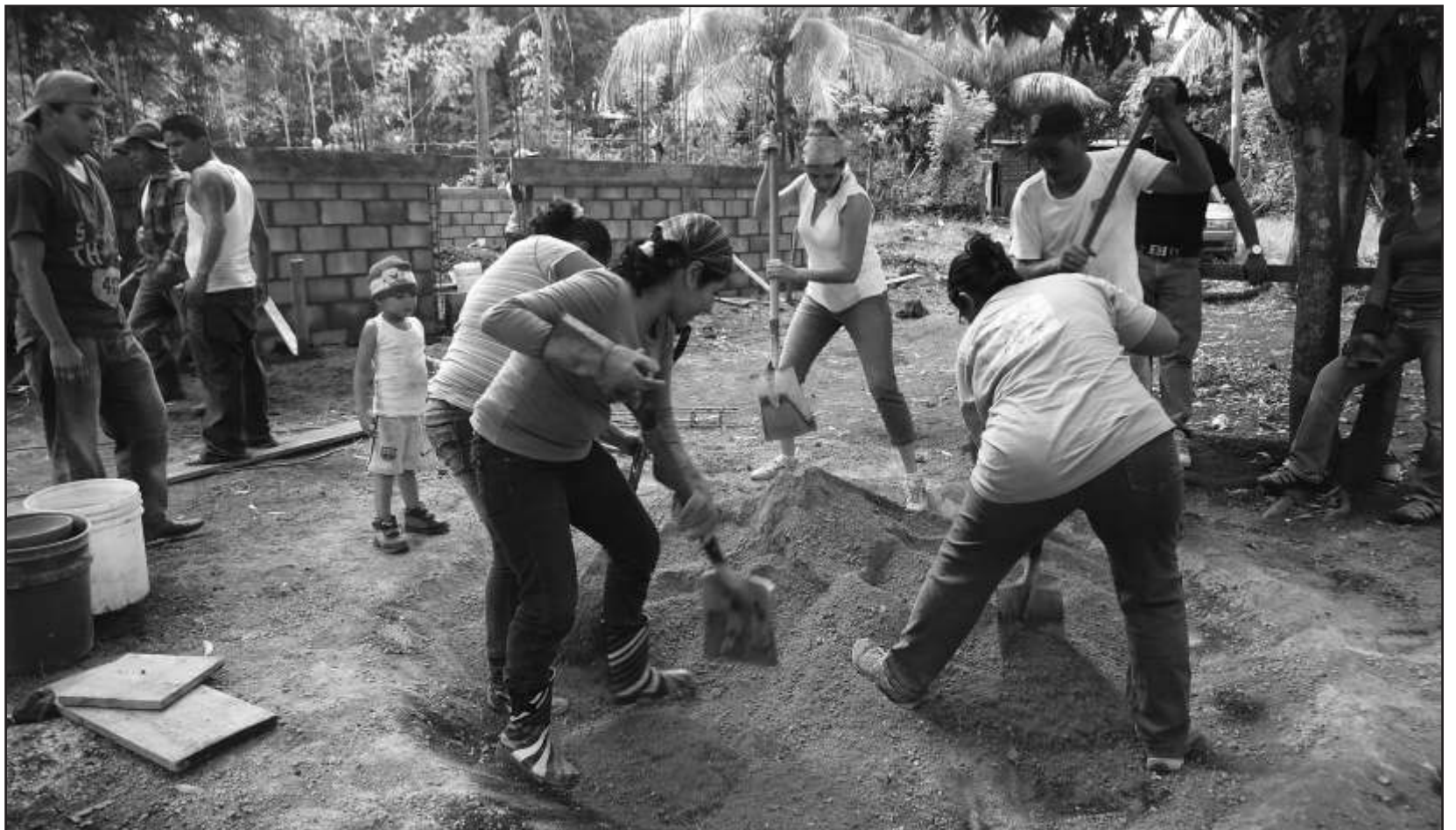
Au Nicaragua, depuis dix ans, près de mille familles se sont organisées en coopératives pour construire leurs quartiers, et quatre-vingt-quatre maisons ont été réalisées par les habitants de banlieues défavorisées de plusieurs villes. DR
